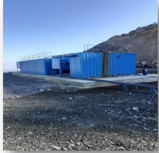
Katı Atık Depolama Sahası Arıtma Tesisi
