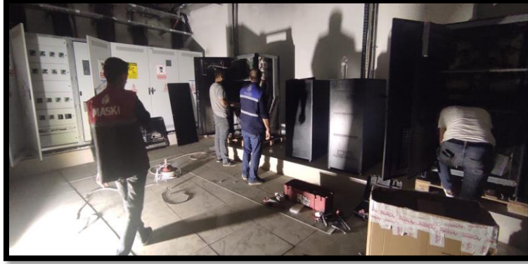
Şekil 11: Genel Müdürlük Binası UPS Bakımı
